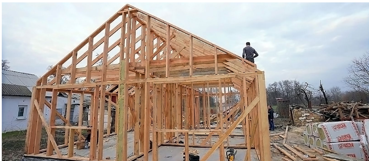
Відновлення зруйнованого житла у Новобасанській громаді, Чернігівської області, 2023 р. Фото: Суспільне Чернігів
