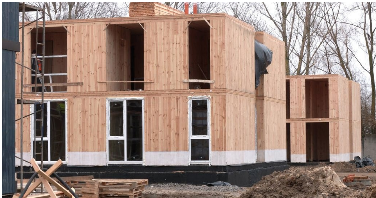
Будівництво дерев'яних будинків у Чернігові для мешканців, які втратили житло внаслідок російської агресії, 2023 рік. Першоджерело: Суспільне Чернігів
