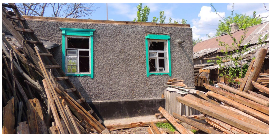
Процес ремонту традиційних сільських будинків, пошкоджених під час першого вторгнення Росії в Україну, 2015 рік. Нижнє, Луганська область. Фото автора
